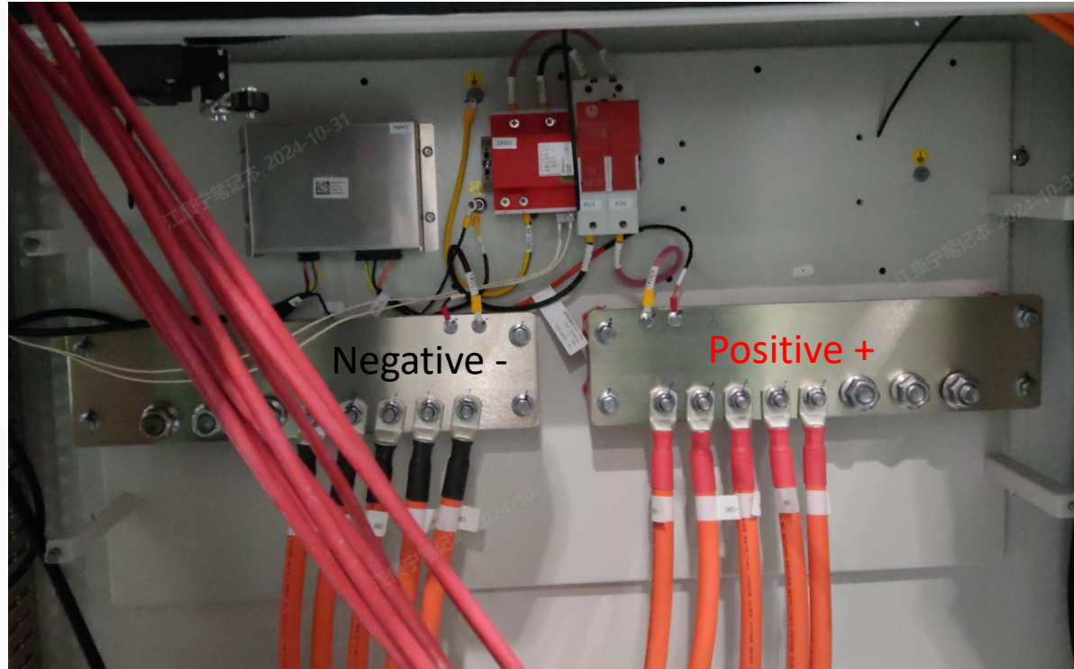
DC Bus--right side
